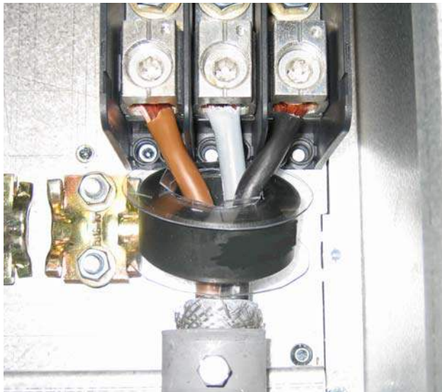
Рис. 49 Ферритовый сердечник установлен на кабелях двигателя
